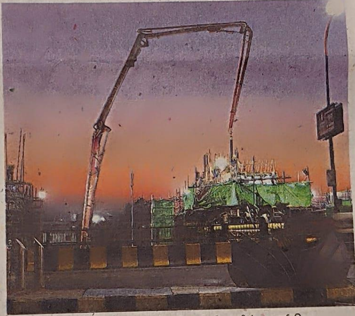
एमआर-10 पर रात को भी मेट्रो लाइन के खंभे का निर्माण जारी है। ● नईदुनिया
