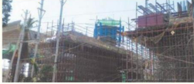
मेट्रो के पहले स्टेशन पर दस में से पांच पिलर पर बेस बनाने का काम पूरा
