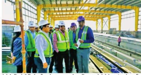
मेट्रो के हिस्से में निर्माणाधीन स्टेशन का अवलोकन किया करते मेट्रो रेल प्रबंधन के एमडी एस. कृष्ण चैतन्य । ● सौजन्य
