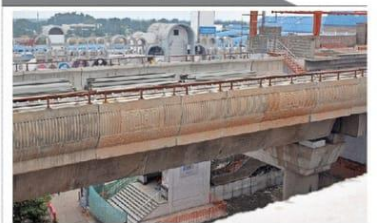
>> रानी कमलापति रेलवे स्टेशन के सामने निर्माणधीन मेट्रो स्टेशन में जाने के लिए सीढ़ियां तैयार करने का काम किया जा रहा है। • नवदुनिया
